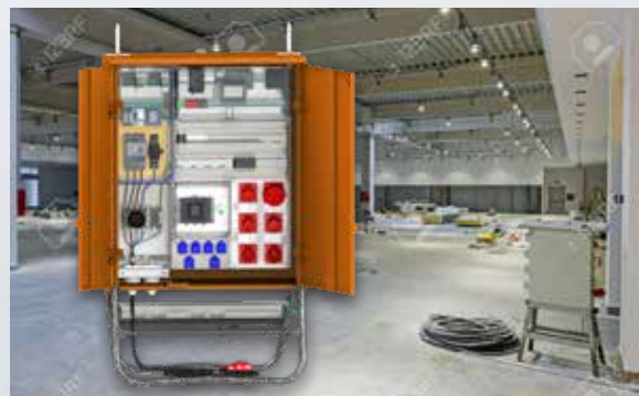
Baustromverteiler / Verteilerabgang (lokal) Distribution Cabinet / distribution outlet (local)
