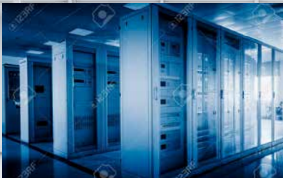
Energieverteilung / Hauptschaltanlage Power distribution / main switchgear
