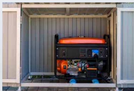
Generador de emergencia estacionario Stationary emergency generator
