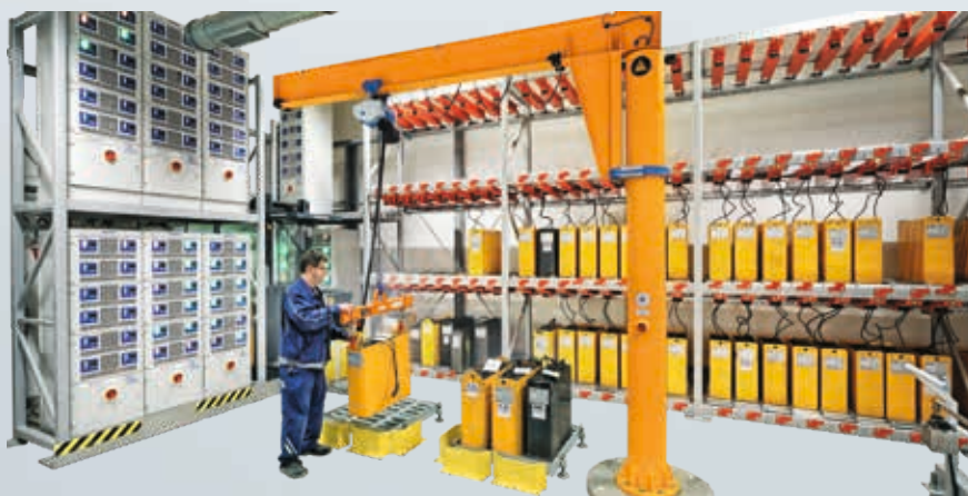
Grua oscilante Pillar swing crane
